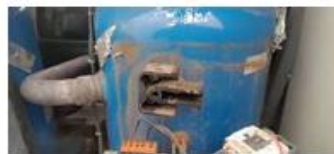
situação que se encontrava o equipamento antes da manutenção corretiva
