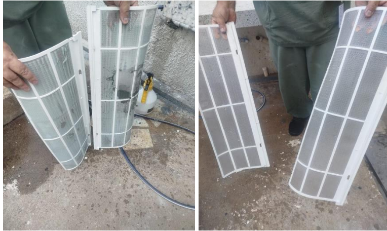
Limpeza de filtros da lavanderia.
