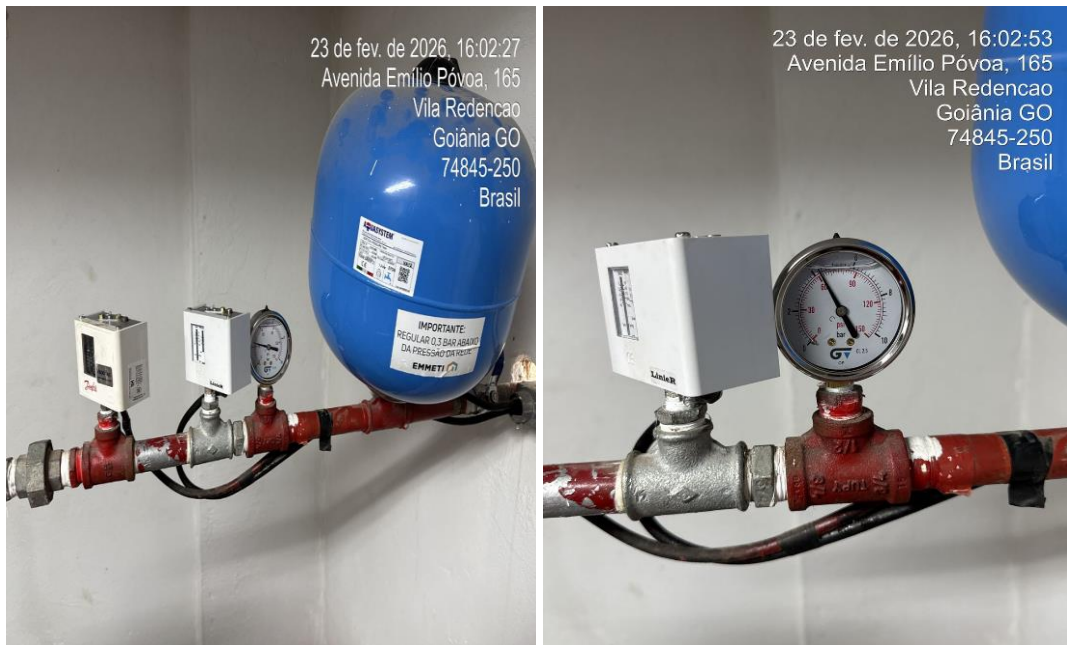
Pressurização da rede automática.
