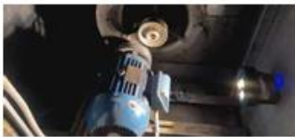
foi feita a remoção da da correia danificada .
