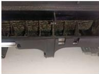
Foi aberto o chamado para o ar condicionado da pediatria, o ar condicionado se encontrava obstruído por sujeira , e com dreno entupido.
