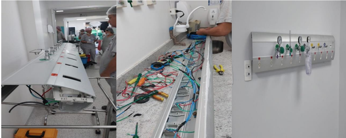
Reparo em régua Centro cirúrgico.
