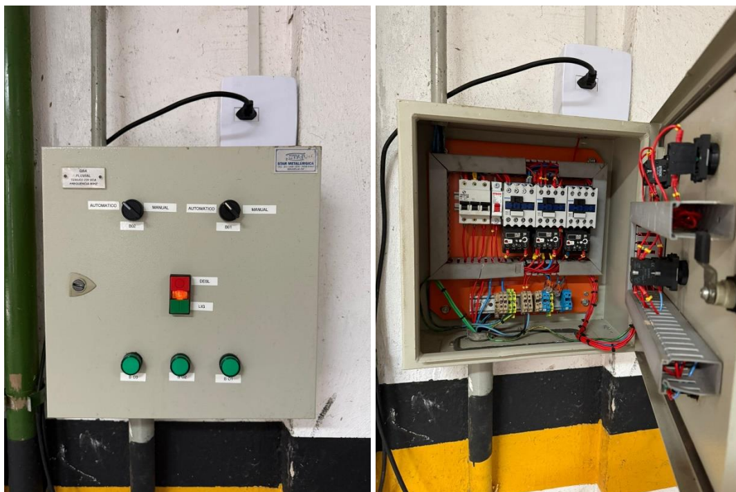
Depois: Quadro reestruturado e automatizado.
