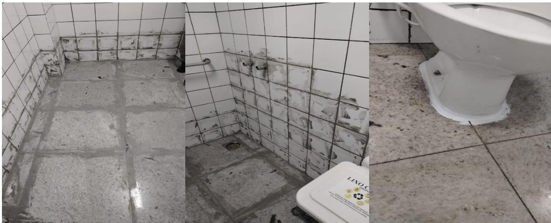
Rejuntamento de banheiro apresentando infiltrações e fixação de vaso sanitário.
