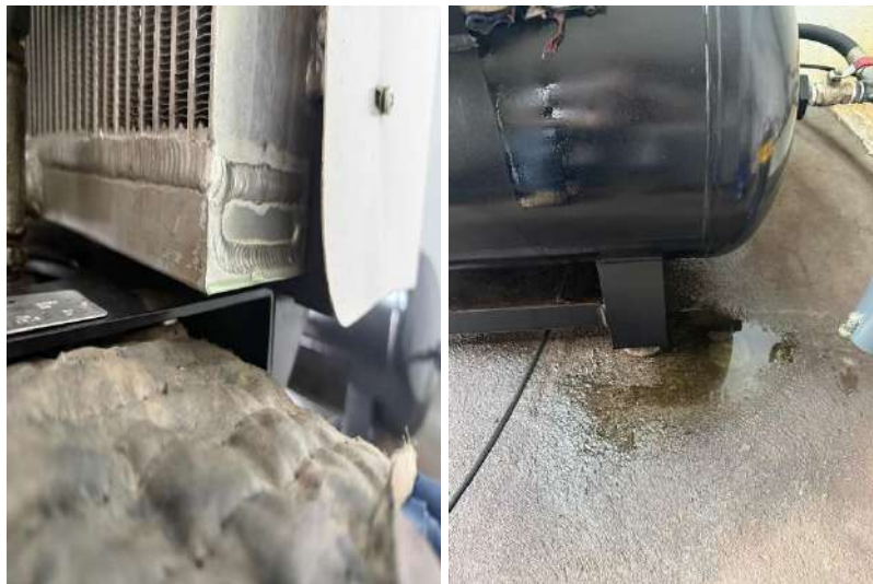
Antes (Patologias encontradas nos Compressores)
