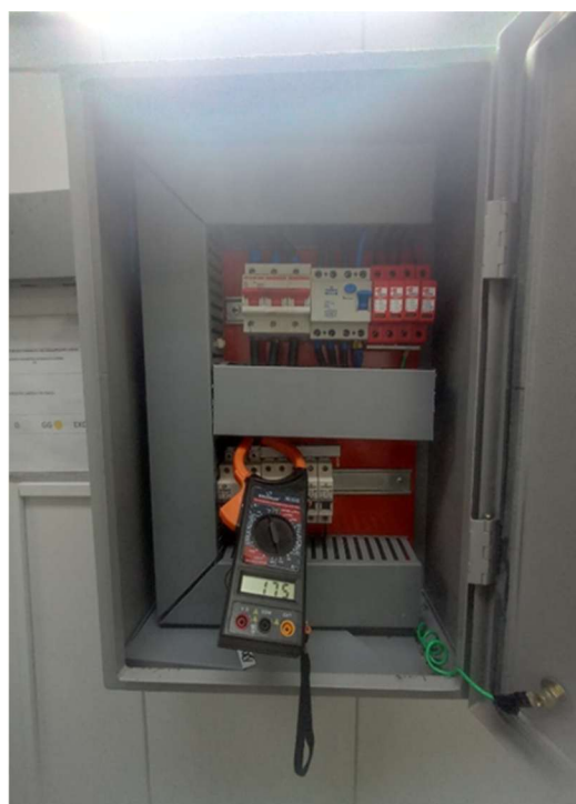
Manutenção preventiva de quadros elétricos
