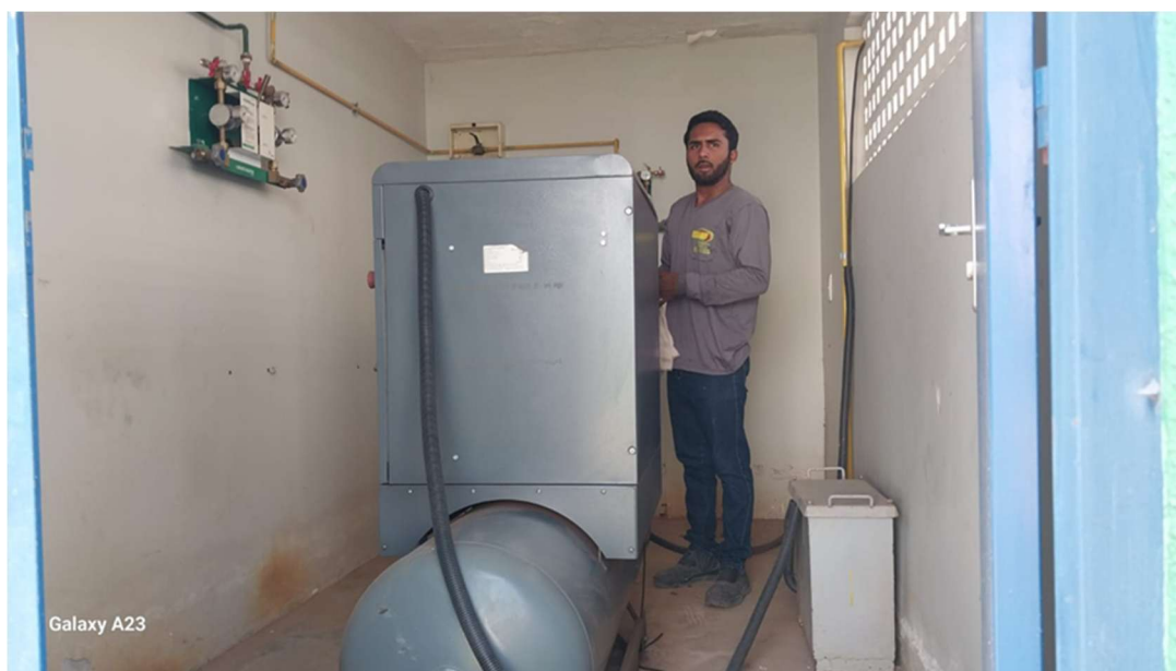
Manutenção preventiva em sistema de gases medicinais
