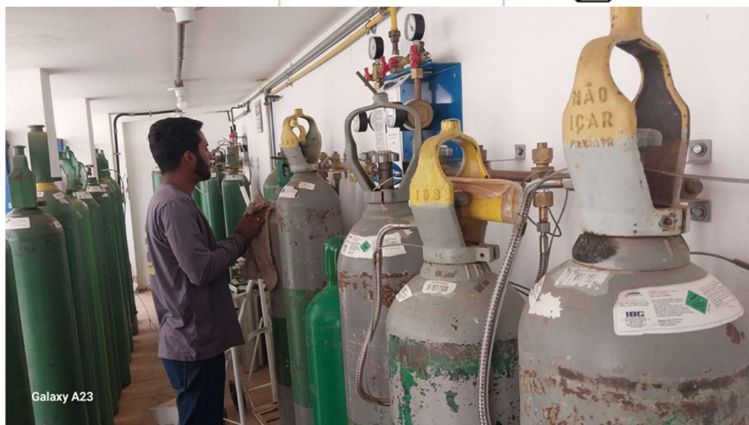
Manutenção preventiva em sistema de gases medicinais
