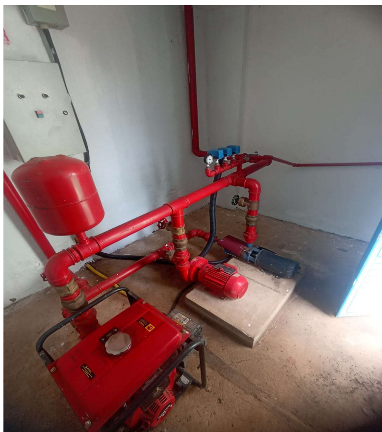
Manutenção preventiva sistema de prevenção e combate a incêndio
