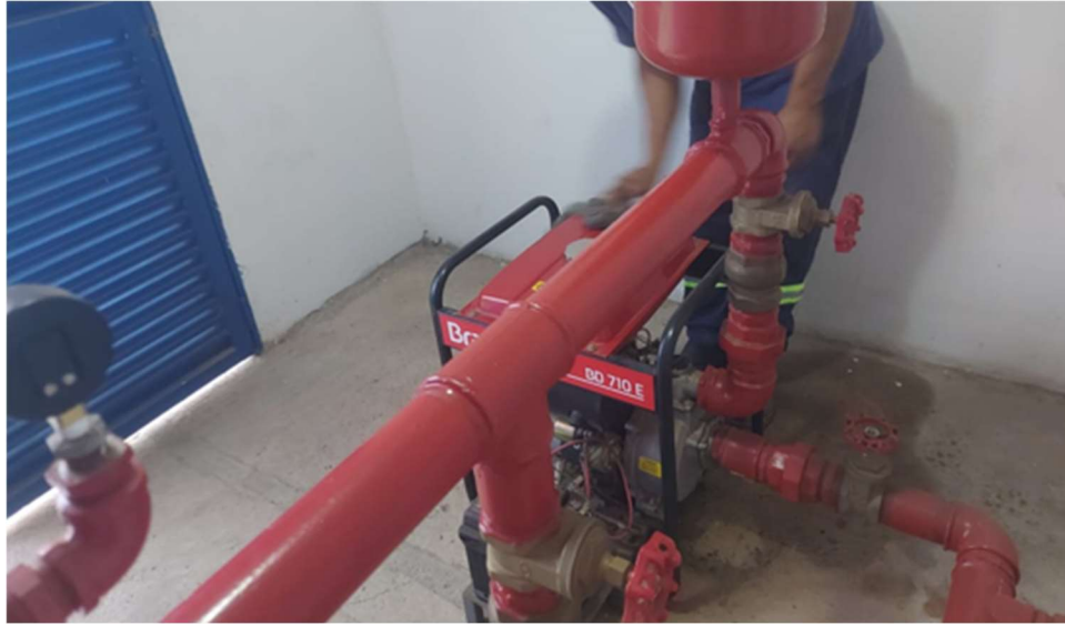
Manutenção preventiva do sistema de prevenção e combate a incêndio
