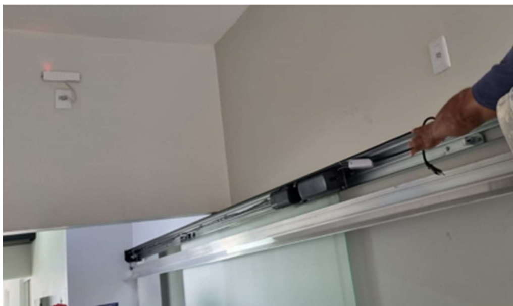
Manutenção preventiva de portas automáticas
