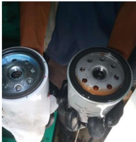
Manutenção preventiva de grupos geradores
