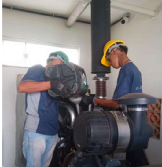
Manutenção preventiva de grupos geradores
