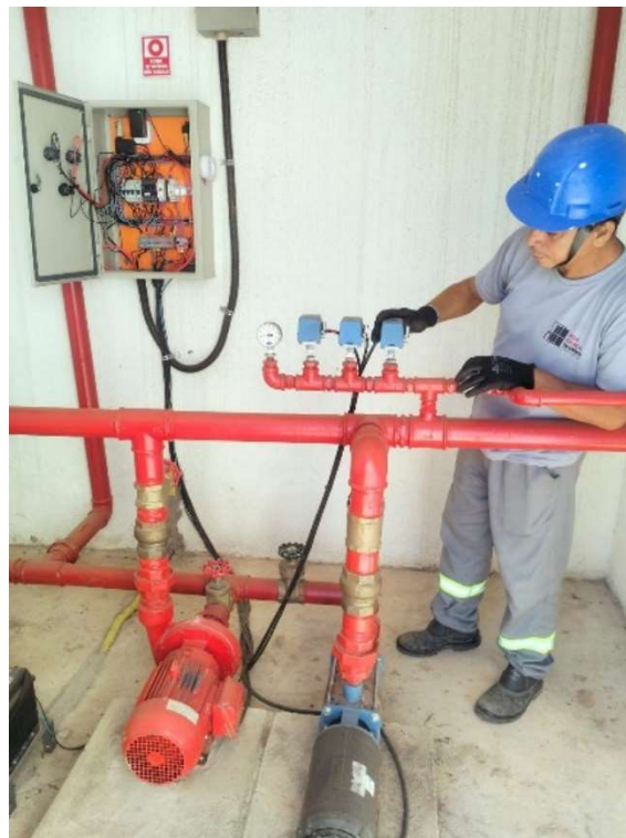
Manutenção preventiva do sistema de prevenção e combate a incêndio
