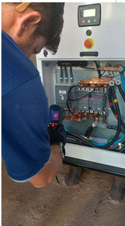
Manutenção preventiva dos grupos geradores
