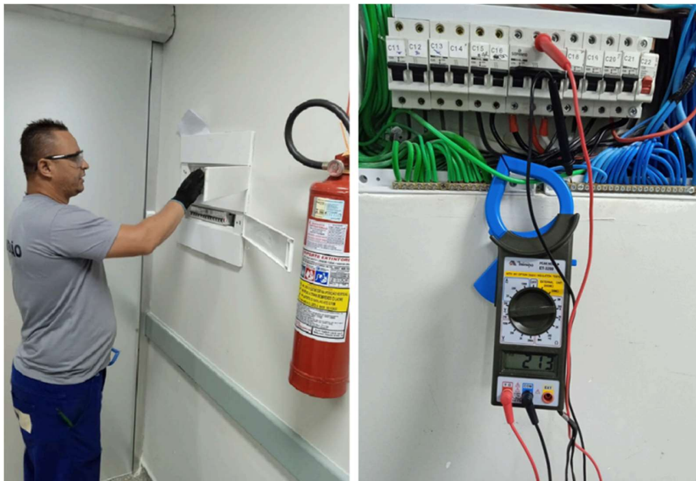
Manutenção preventiva de quadros elétricos
